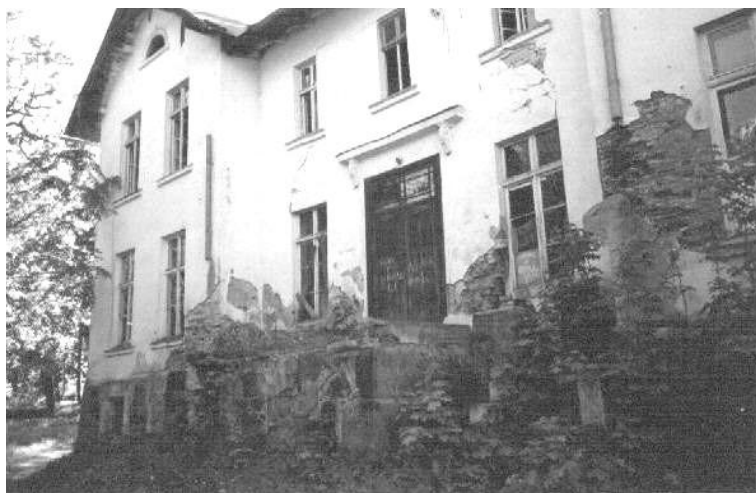
Gutshaus Groß Mierau Süd-Ost-Seite mit ehemaliger Veranda 2004: Es steht leer und verfällt zusehends.
